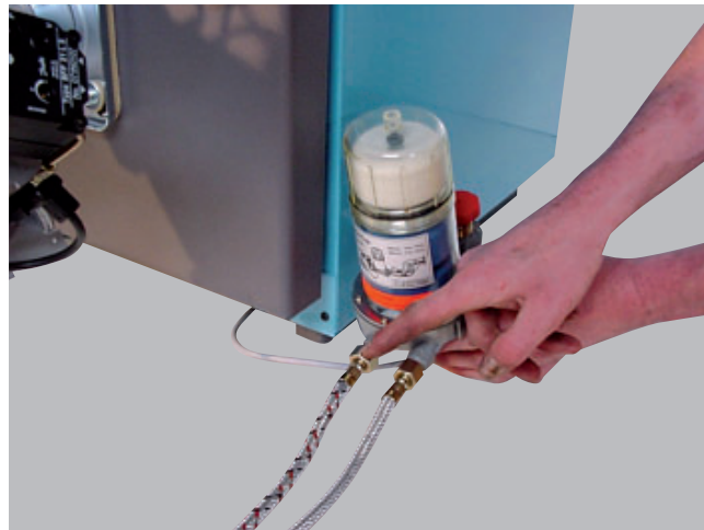
Der gemusterte Ölschlauch ist die Ansaugleitung.
